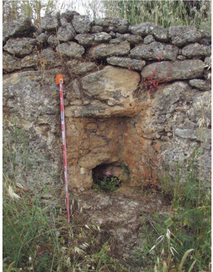
Foto 11. Desarenador junto a antigua carretera de Gaucín. Photo 11. Sand trap next to the old Gaucín road.
