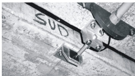
Figura 3. Sensor de desplazamiento (FPI) como medidor de juntas
