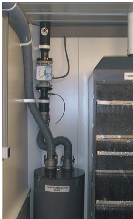
Foto 11. Filtro carbón activo gases y rotámetro
