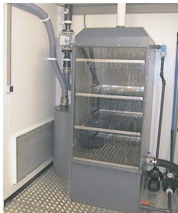
Foto 6. Torre de aireación
