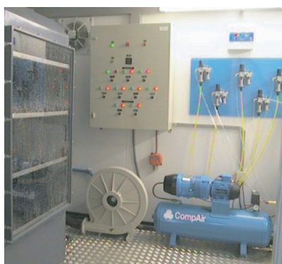
Foto 8. Compresor y soplante
