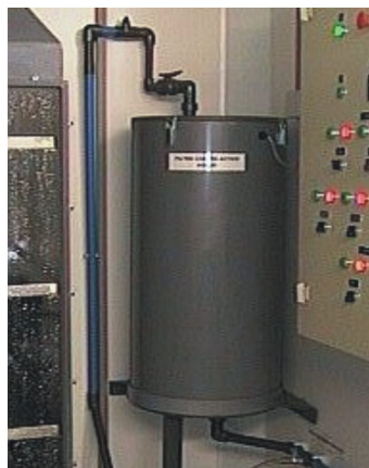
Foto 7. Filtro de carbón aguas
