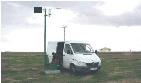
Figura 3. Mantenimiento de equipos de la red de piezometría y calidad de aguas subterráneas
