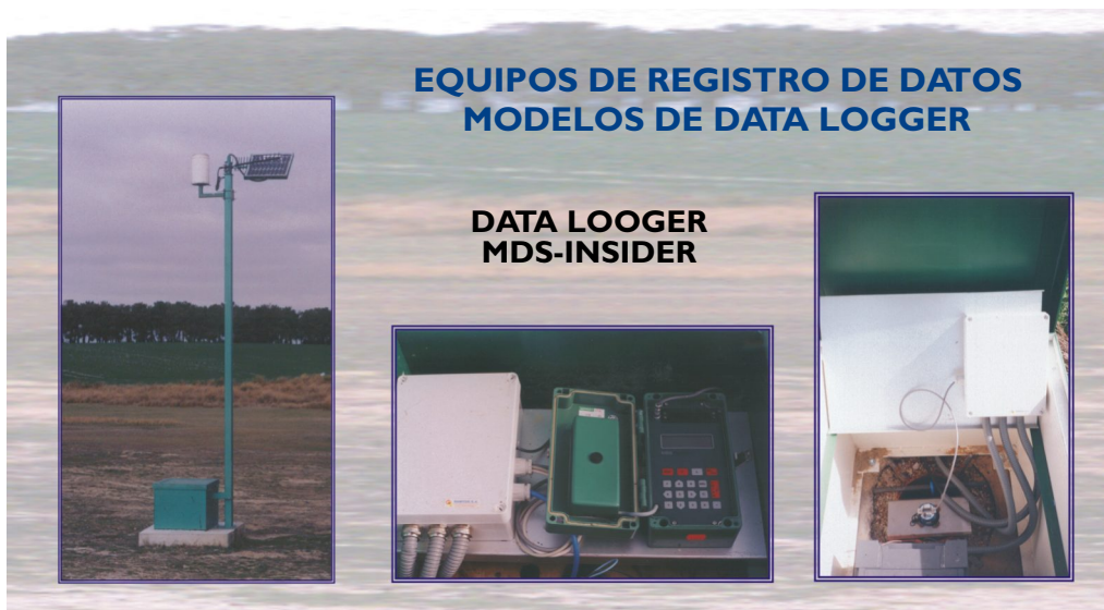
Figura 5. Equipos data logger y aspecto general de las instalaciones
