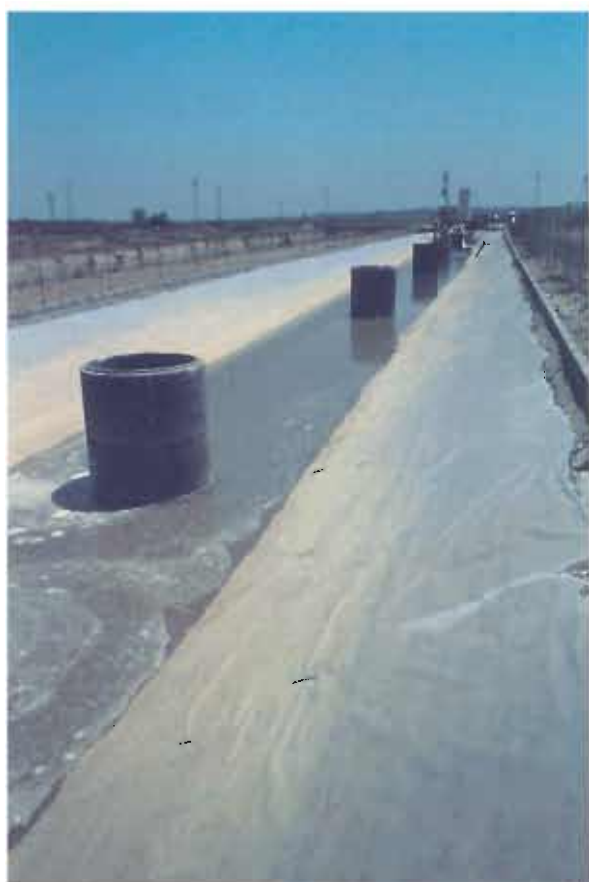
La erosión de los taludes es en ocasiones causa de colmatación. Su revestimiento con material geotextil contribuye eficazmente a reducir este problema.
