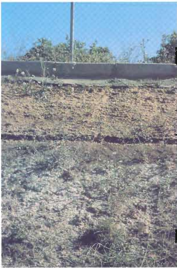
Los efectos no deseados del oleaje sobre los taludes de las balsas pueden provocar problemas de deslizamiento, e incluso hundimiento.
