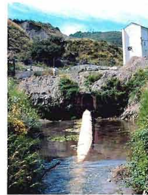
Manantial y captaciones de la Fuenzaca (Alhaurín de la Torre) en el acuífero de la Sierra de Mijas. (64)
